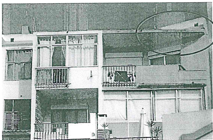
F4 – Remate da pala da varanda no tardo do edifício
