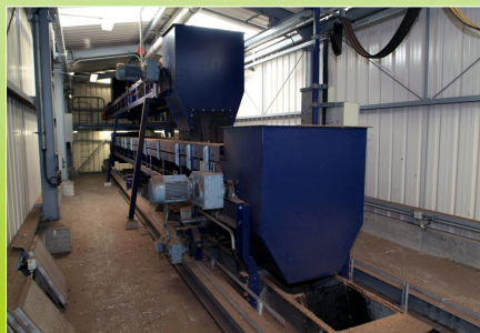
Alimentação dos túneis
