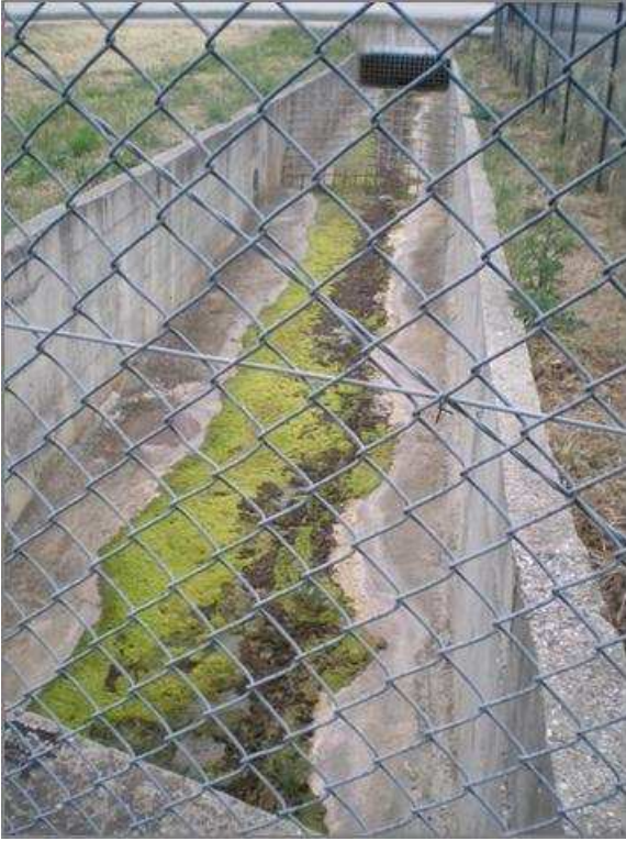
Figura 51 Troço canalizado no aeródromo de Tires
