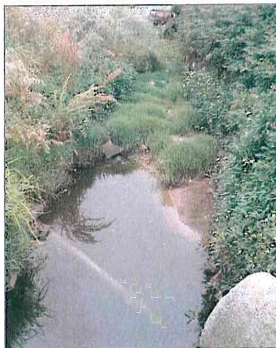
Figura 48 Leito totalmente artificializado
