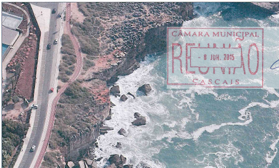
Figura 33 Instabilidade do tipo Tombamento ou Balançamento
