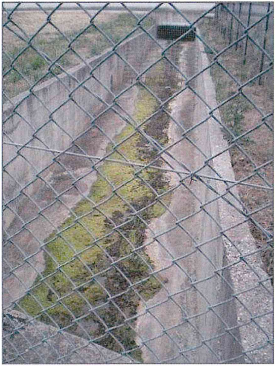
Figura 51 Troço canalizado no aeródromo de Tires
