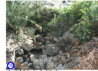
10 Instabilidade do talude - margem esquerda
