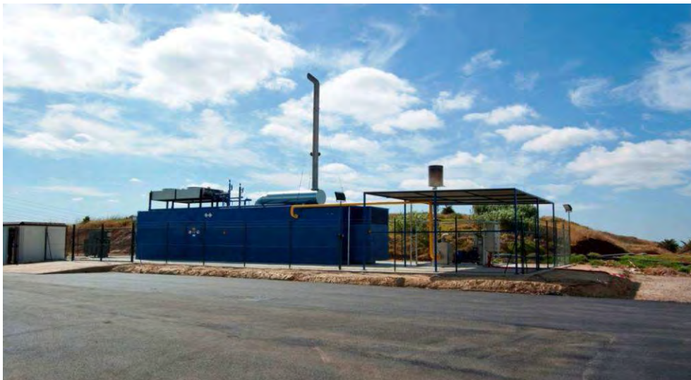
Figura nº 229 Centro electroprodutor do biogás do aterro de Trajouce
