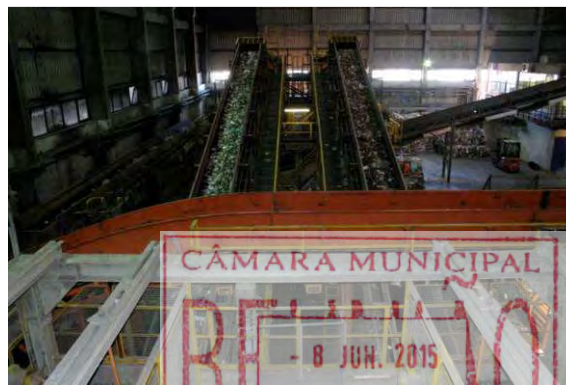
Figura nº 222 Pormenor dos tapetes transportadores de material < 120 mm
