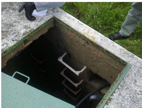
Figura 1 – Caixa para injeção de cloro em conduta
