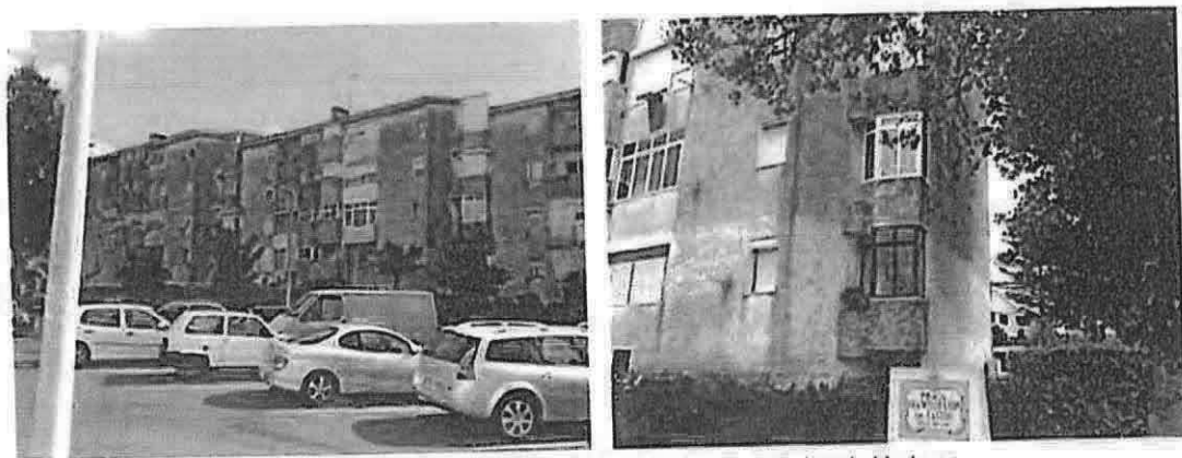
Figura 50. Estado de conservação das fachadas do Bairro da Madorna
