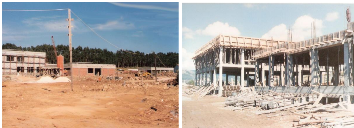
Imagem 2: Durante as obras de construção - anos 80 – Fotos retiradas do site do Agrupamento Ibn Mucana
