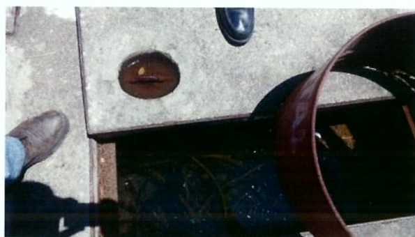
Caixa de Passagem de cabos Electricos "mergulhados em água"
